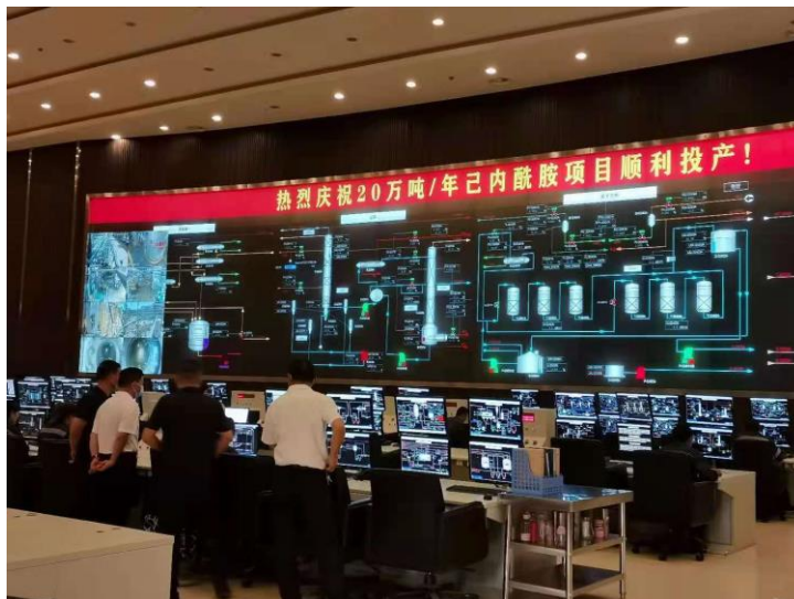
图为调研组一行在庆华集团腾格里化工公司调度室参观
