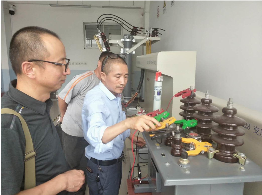
专家组对高压电实操培训考试设备进行现场检查
